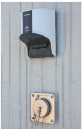
外壁に設置した住宅の給電インレット。車から直接つないで使用します
