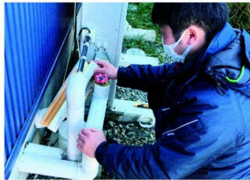
給水管の保温材の交換も定期的に行うのが理想です
