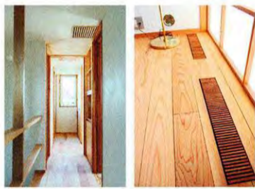
天井と床に設けられた空調用の通気口。=いずれも甲府市
